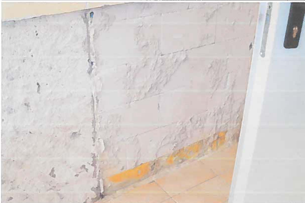
Fot. 5. Skutki oddziaływania wilgoci na ściany wewnętrzne budynku
