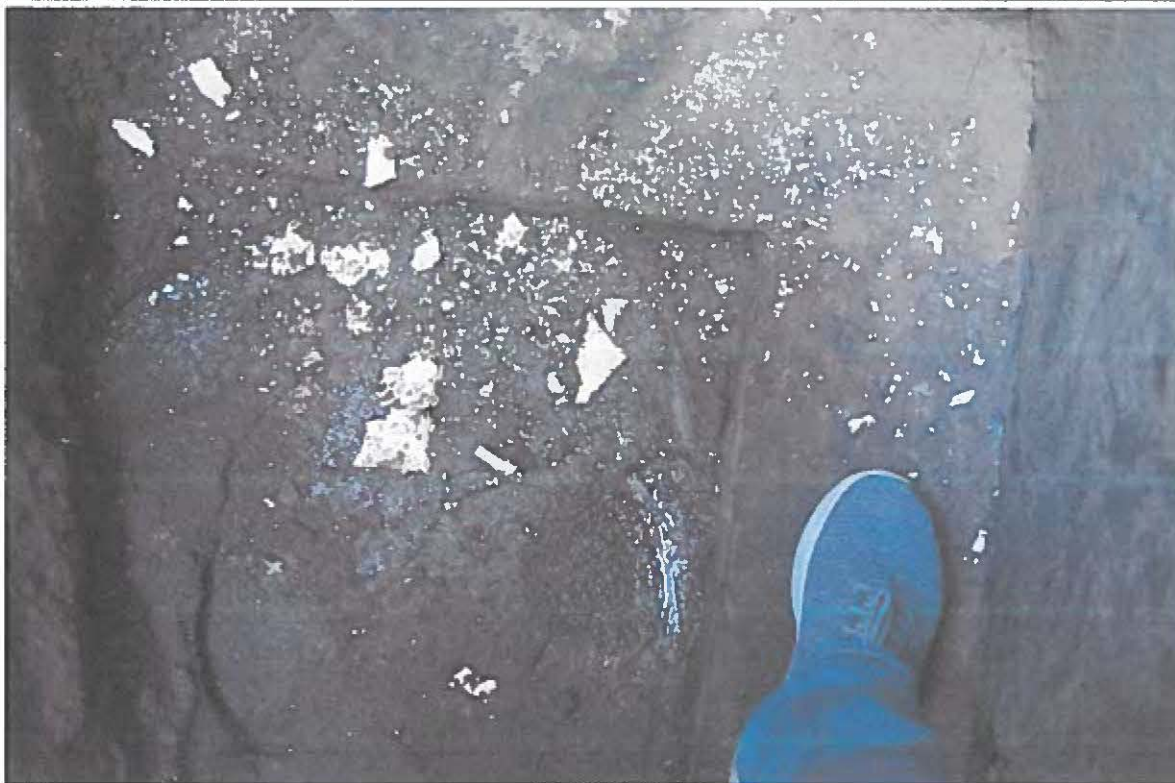
Fot. 7. Woda na dnie wykopu
