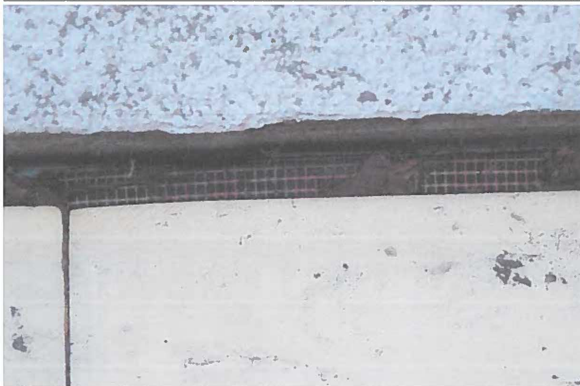
Fot. 3. Szczelina pomiędzy płytami izolacji termicznej
