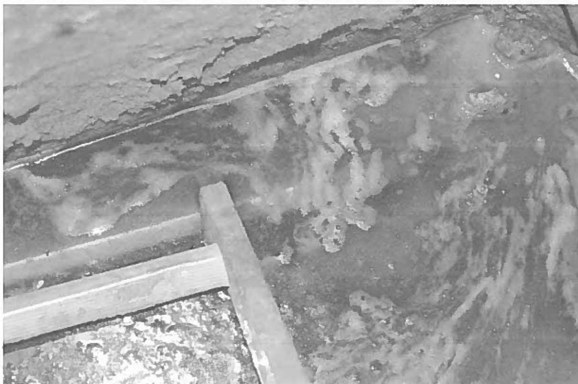
Fot. 3. Woda na dnie wykopu
